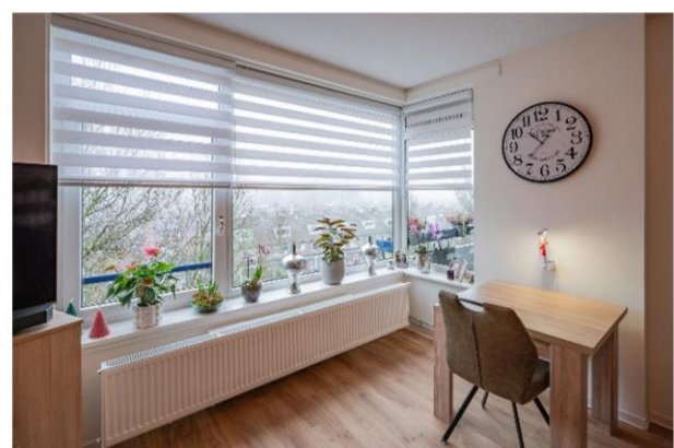
Ventilatie/Verwarming -unit woonkamer
